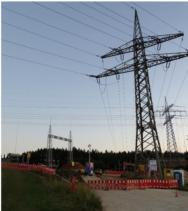
Neubau der Trafostation beim Umspannwerk zwischen Kleinkuchen und Rotensohl
